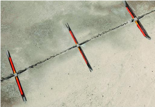
Figur 3. Placering av ankarna i de spår som har gjorts vid spricköppningen.
