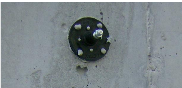
Figur 1. Placering av den ytmonterade nippeln på spricköppningen.
