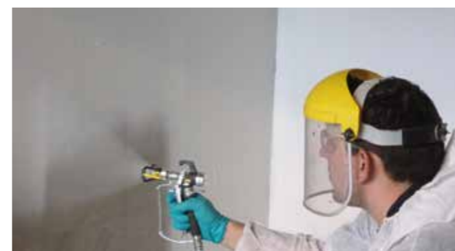
Sprutpåföring av MasterProtect 330 EL som spricköverbryggande och karbonatiseringshämmande skydd av väggar i parkeringsanläggningar.
