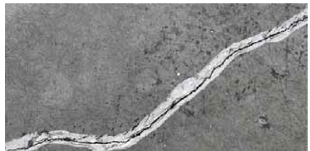
Obr. 2 Žliabok v tvare písmena V na trhlíne
