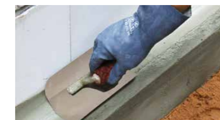
Confeção de meias canas com MasterEmaco N para criar uma continuidade na impermeabilização da estrutura.
