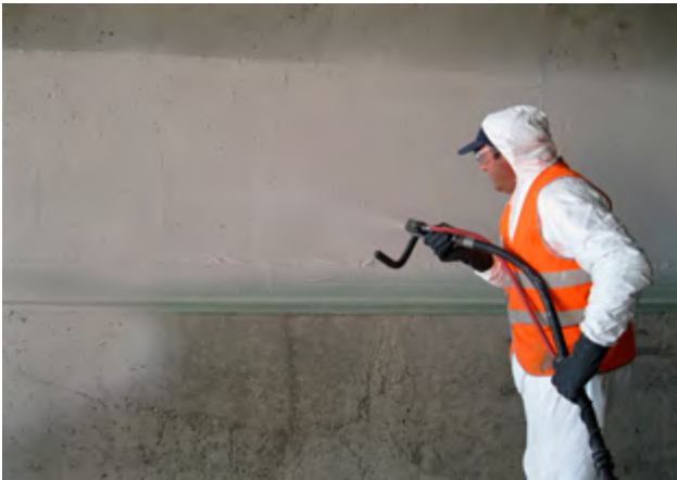
Rys. 2. Nakładanie natryskowe MasterProtect 7700 na ścianę boczną tunelu przy użyciu urządzenia do natryskiwania.
