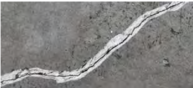
Rys. 2. Bruzda w kształcie litery V w otworze pęknięcia.
