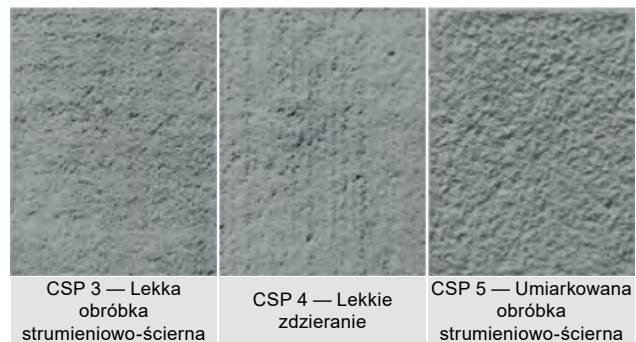
Rysunek 1. Profile powierzchni betonowych.
