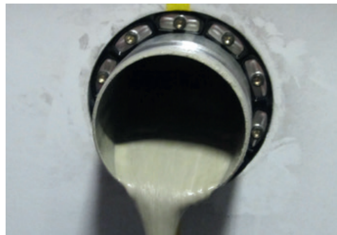
ボルト接合部とグラウトのオーバーフロー
