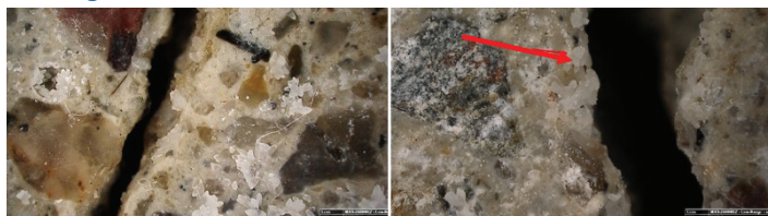
Agrandissement d'une fissure capillaire dans le béton
