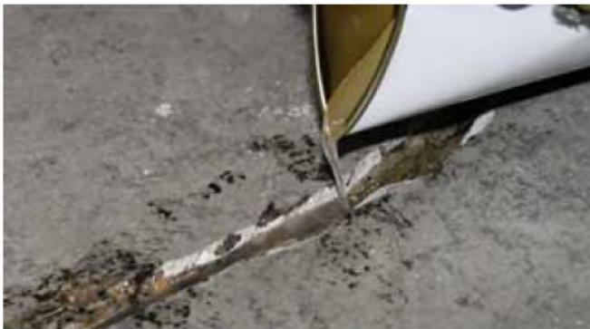
Figure 5: Verser MasterInject 1360 directement dans les fissures qui sont coupées en forme de V.
