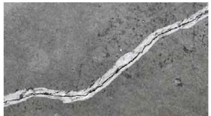
Figure 3: rainure en forme de V dans la fissure.
