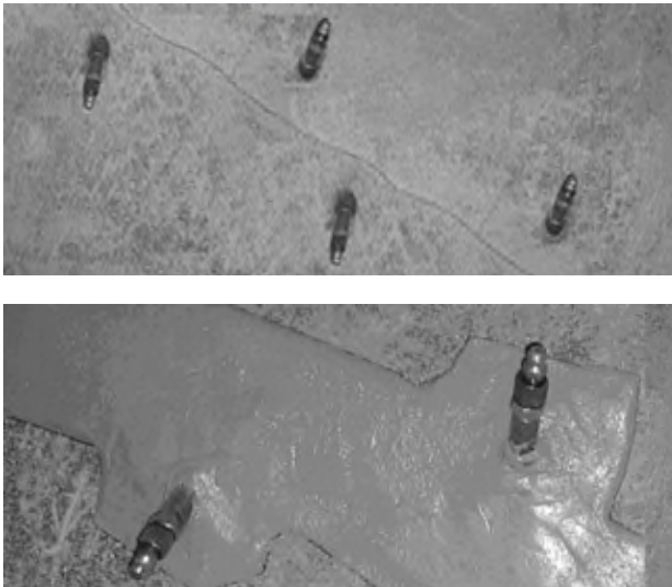
Figure 1: supports d'injecteurs type douille placés autour de la fissure et bouchés avec un colle époxydique approprié de la gamme MasterInject.
