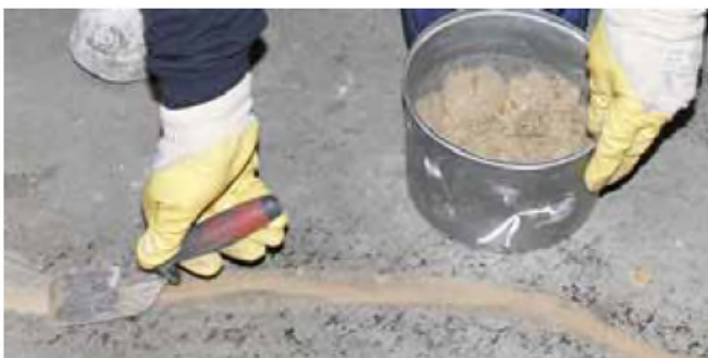
Figure 6: Egaliser la surface des fissures à l'aide d'un mortier approprié de la gamme MasterInject / MasterFlow.
