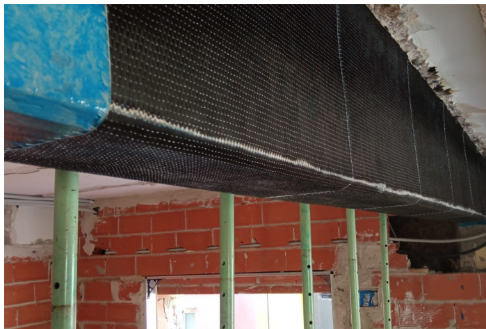
Diferentes momentos de la ejecución de los trabajos de refuerzo con MasterBrace
