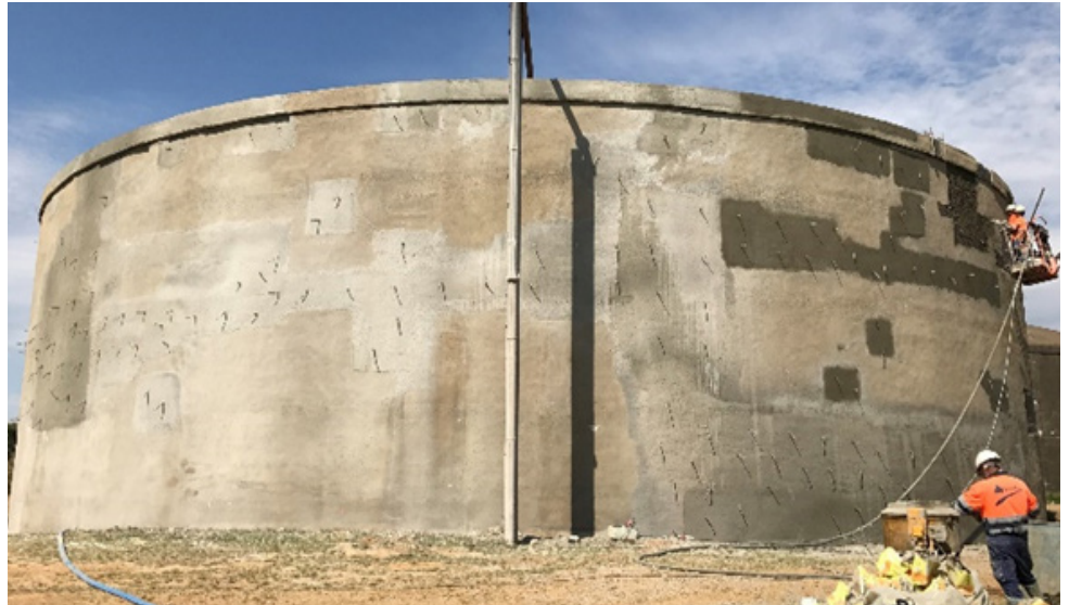
Rehabilitación exterior: reparación, inyección, refuerzo con postesado, y protección con inhibidor y realcalinizador
