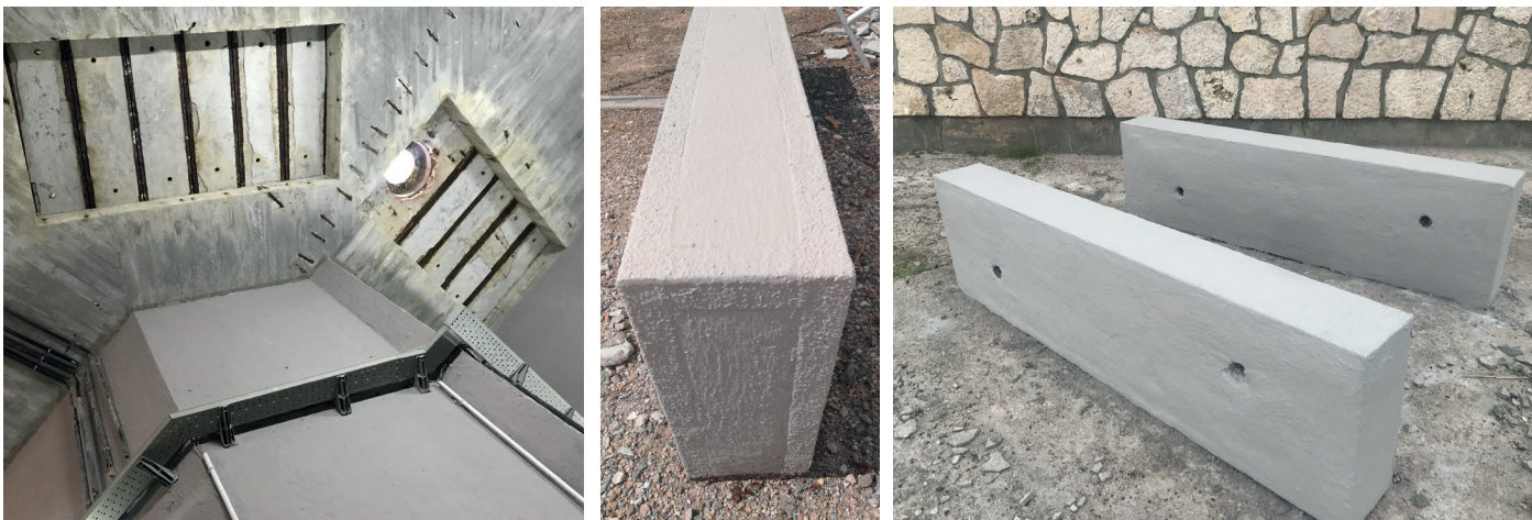
Estado y inicial y final de las cobijas tras reparación y protección con materiales de la gama MasterEmaco y MasterSeal
