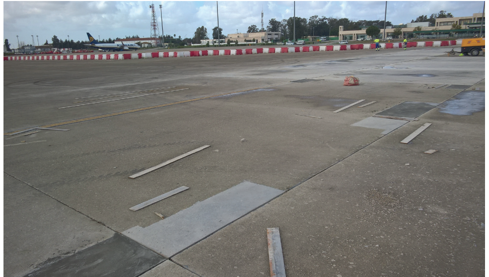
Reparación del hormigón de la plataforma de estacionamiento del aeropuerto de Jerez de la Frontera
