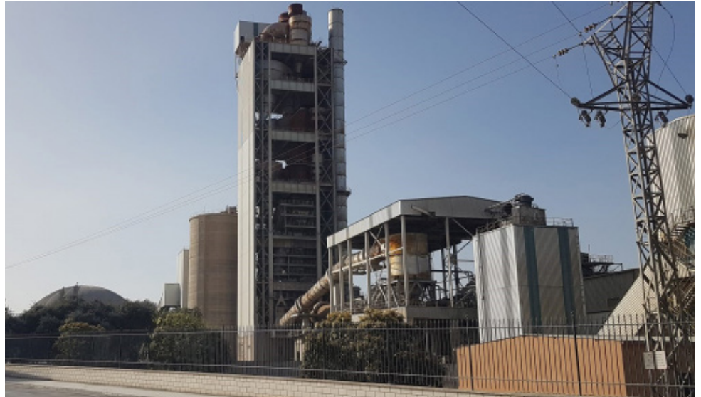
Protección e impermeabilización de la estructura metálica del casetón de la cementera
