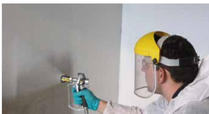
Sprøjtepåføring af MasterProtect 330 EL som revneoverbyggende og karbonatiseringshæmmende beskyttelse af vægge i parkeringsanlæg.
