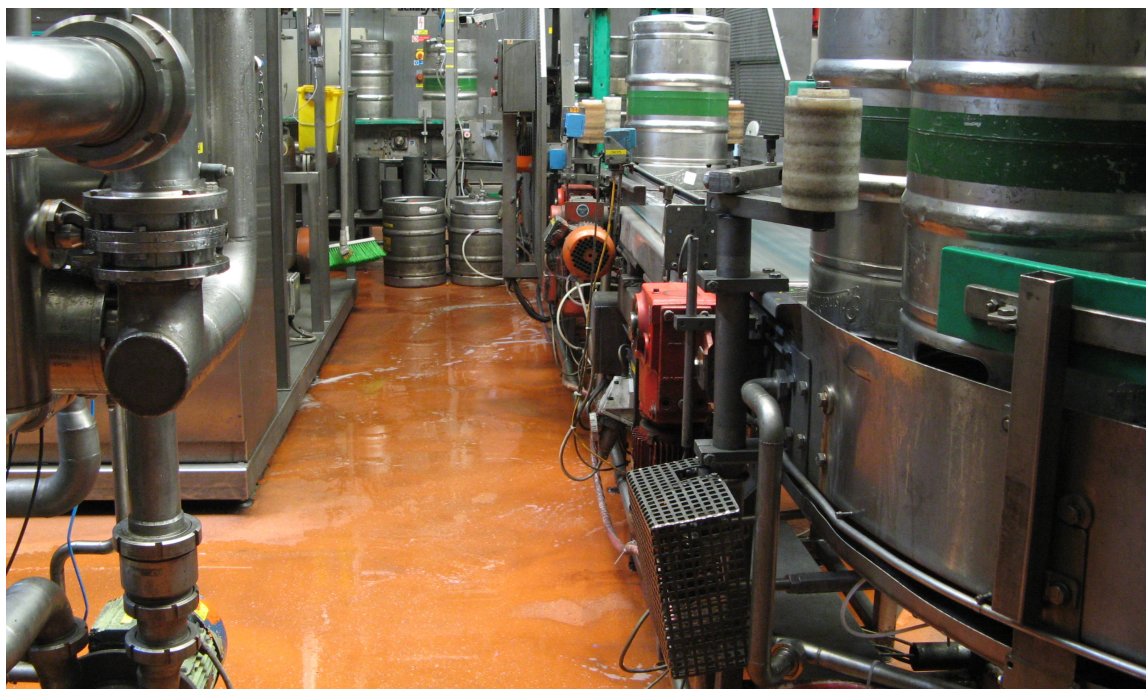
Naše reference v Nošovicích (CZ): Pivovar Radegast – rekonstrukce podlahy stáčírny sudů KEG
