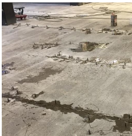
Det revnede og delvist løse underlag blev injiceret med MasterInject 1360.
