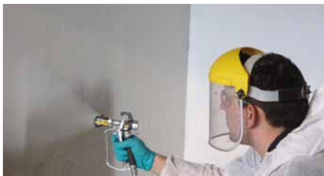
Påføring med sprøyte av MasterProtect 330 EL som rissoverbyggende karbonatiseringshemmende beskyttelse av vegg i parkeringsanlegg.
